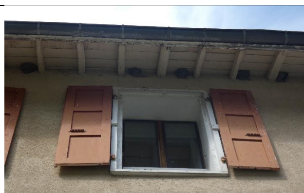
Nids sous dépassé de toit
